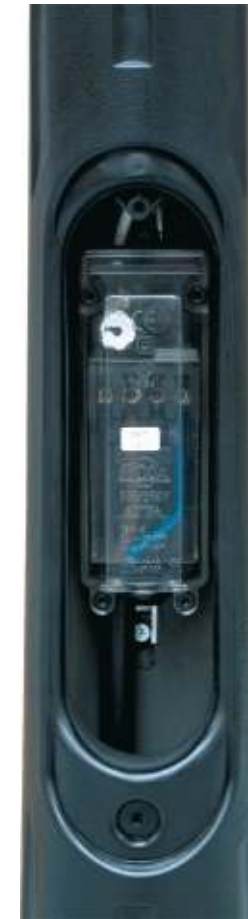
Вводный щиток в нише стальной опоры с внешним покрытием из синтетического материала
