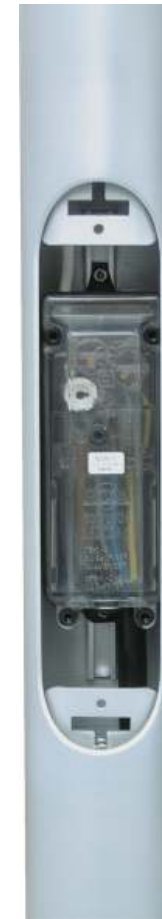
Вводный щиток в нише алюминиевой опоры
