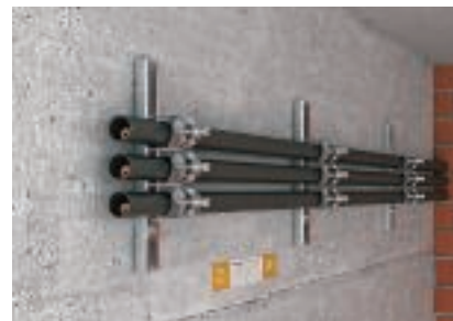
Компактный монтаж нескольких труб рядом друг с другом с зажимными скобами
