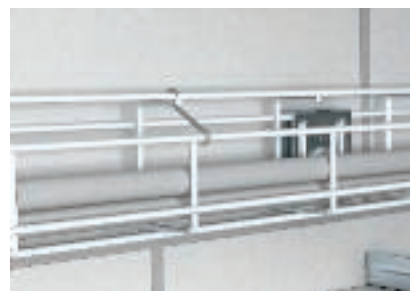
Предохранительный крюк в корректном положении
