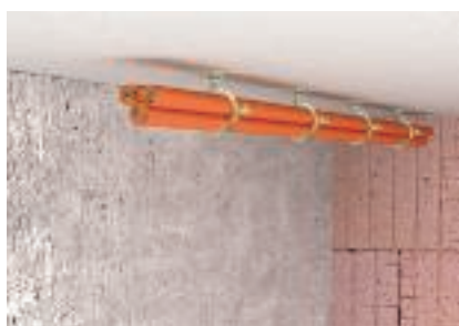
Пучки проложенных под потолком кабелей
