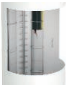
Бандажированные вертикальные трассы в башне ветровой установки
