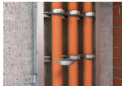
Прокладка кабелей с зажимной скобой на перекладинах вертикального кабельного лотка лестничного типа
