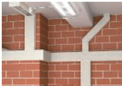
Установленный огнестойкий короб на стене и потолке класса I и E
