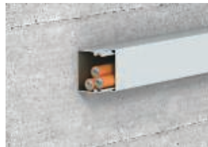
Чистая прокладка кабелей данных и кабелей пожарной сигнализации в коробе типа 20030
