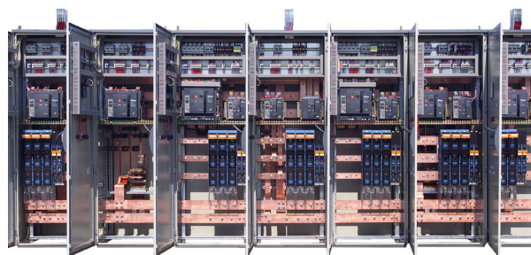
Главные распределительные щиты
