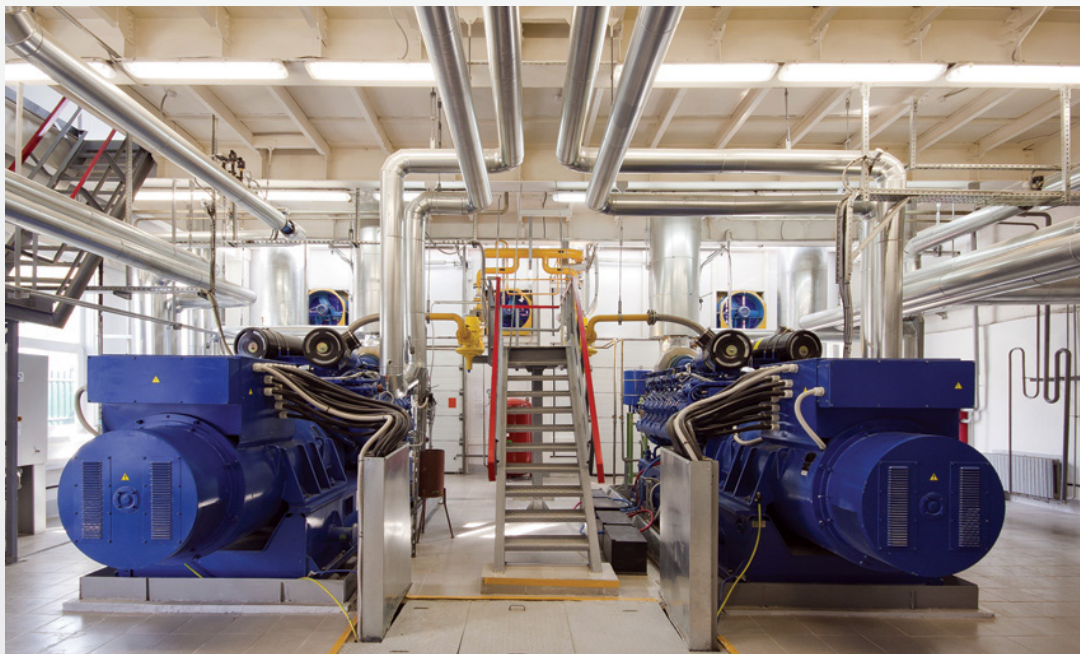
Исполнение в здании ТЭЦ
