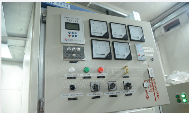
Щит с автоматикой РЗиА
