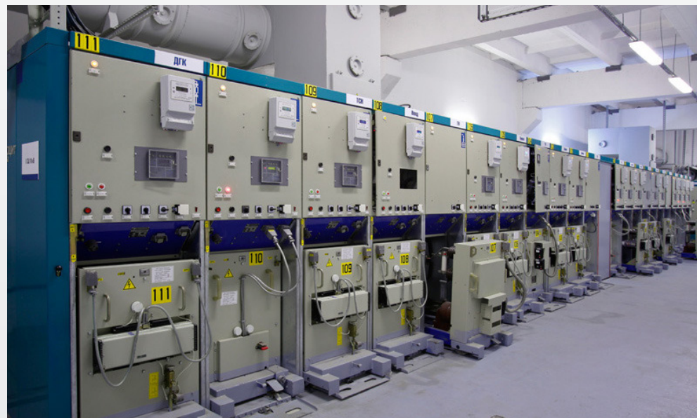
КРУ - 10 кВ в составе энергоцентра ГПУ
