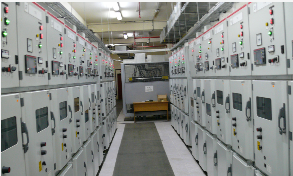
ЗРУ - 10 кВ в составе комплекса ДЭС
