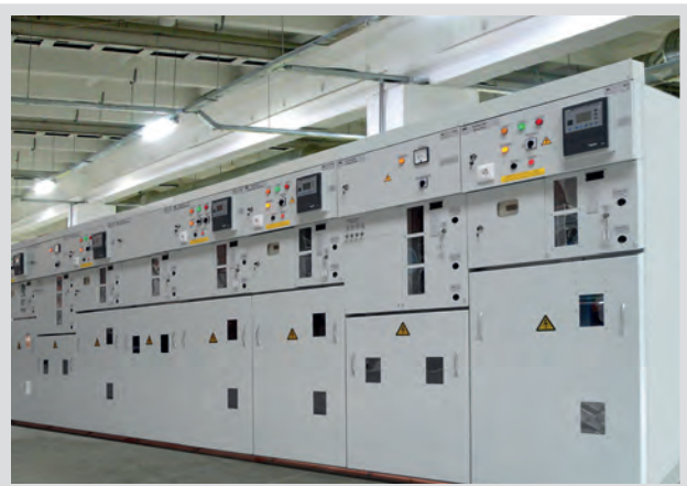
РУ-6(10) на базе камер КСО «Оскол» - внутрицеховая установка.
