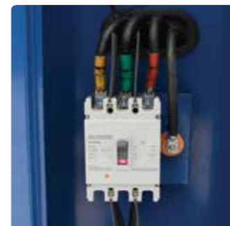
Автомат защиты генератора
